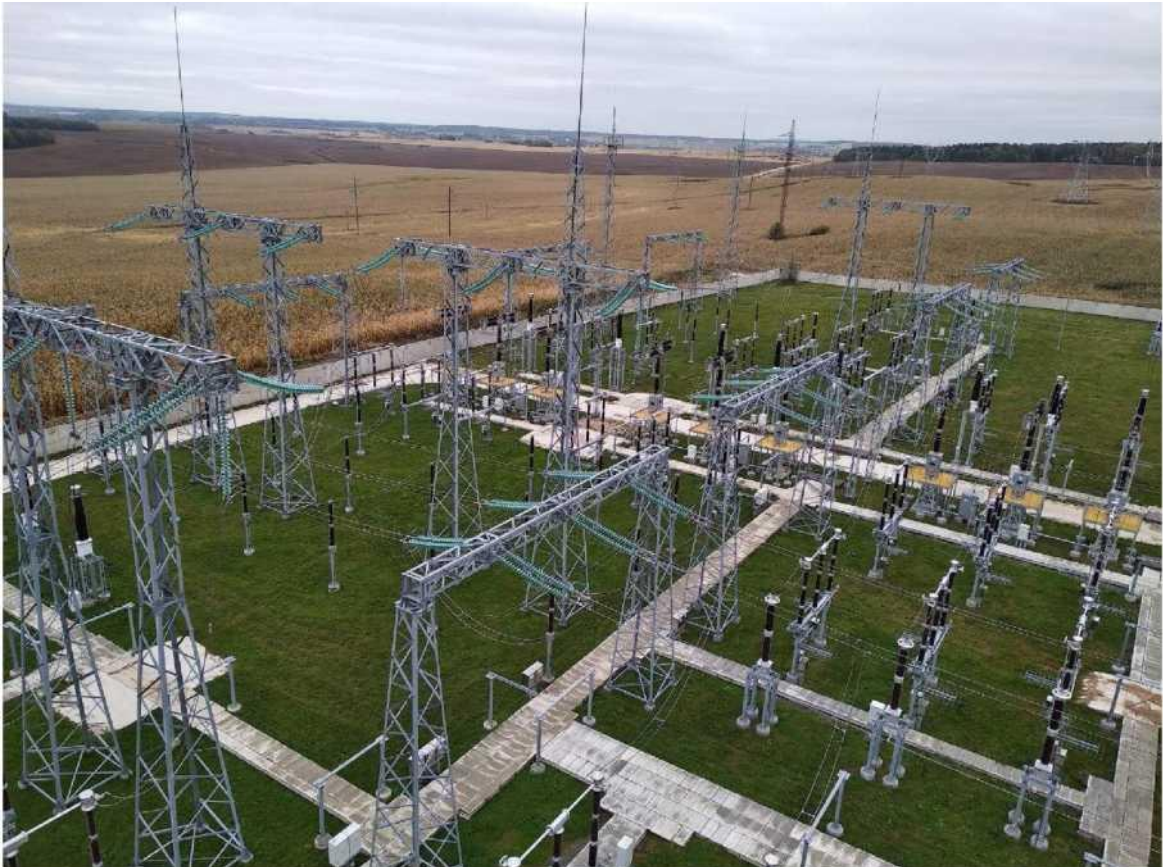
Реконструкция ПС 330/110/10 кВ «Минск Северная» с заходами 110 кВ Минского района Минской области (корректировка);
